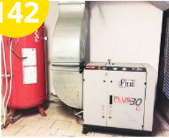
IMPIANTO GENERAZIONE ARIA + IMPIANTO ASPIRAZIONE € 8.000
