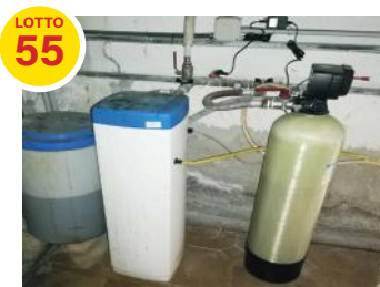
IMPIANTO ADDOLCIMENTO di tipo cronometrico
