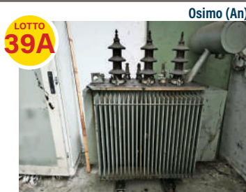
TRASFORMATORE 320 Kwh - matricola 524243
